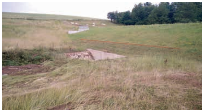
Až sem sahala voda.
